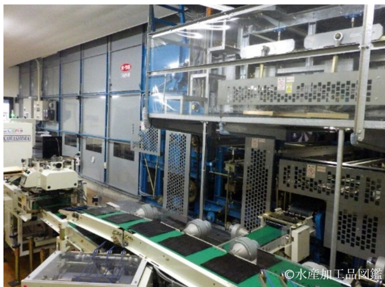
写真2 全自動乾燥機 (提供：「心和水産」柳川市大和町)
